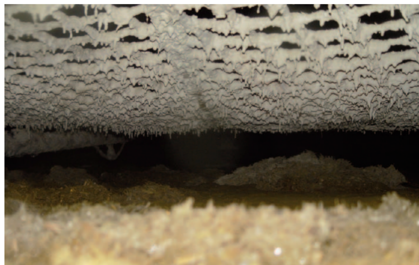
Blick in den Fermenter, Schwefel am Netz
