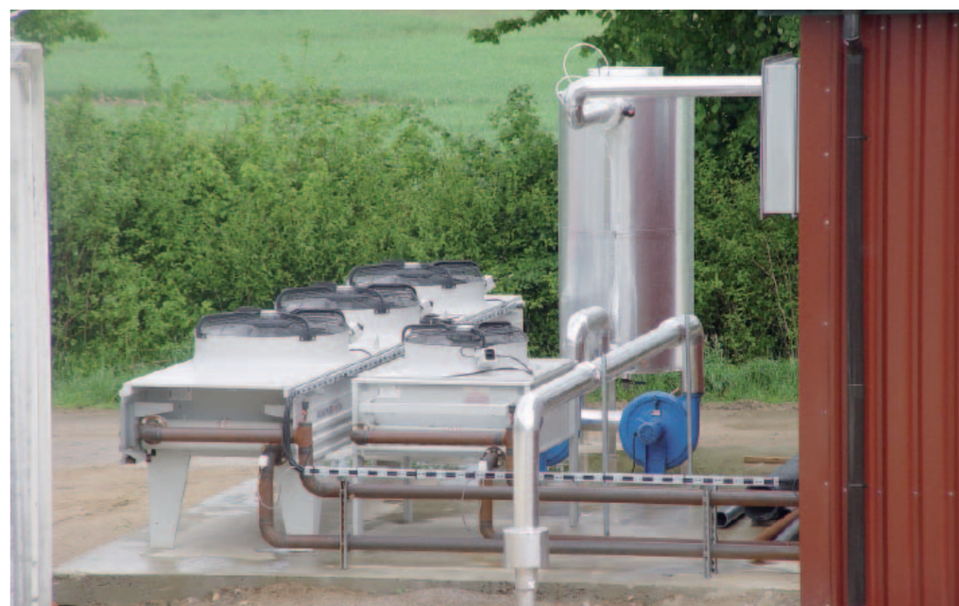
Kohlefilter zur Gasreinigung, Motorkühler
