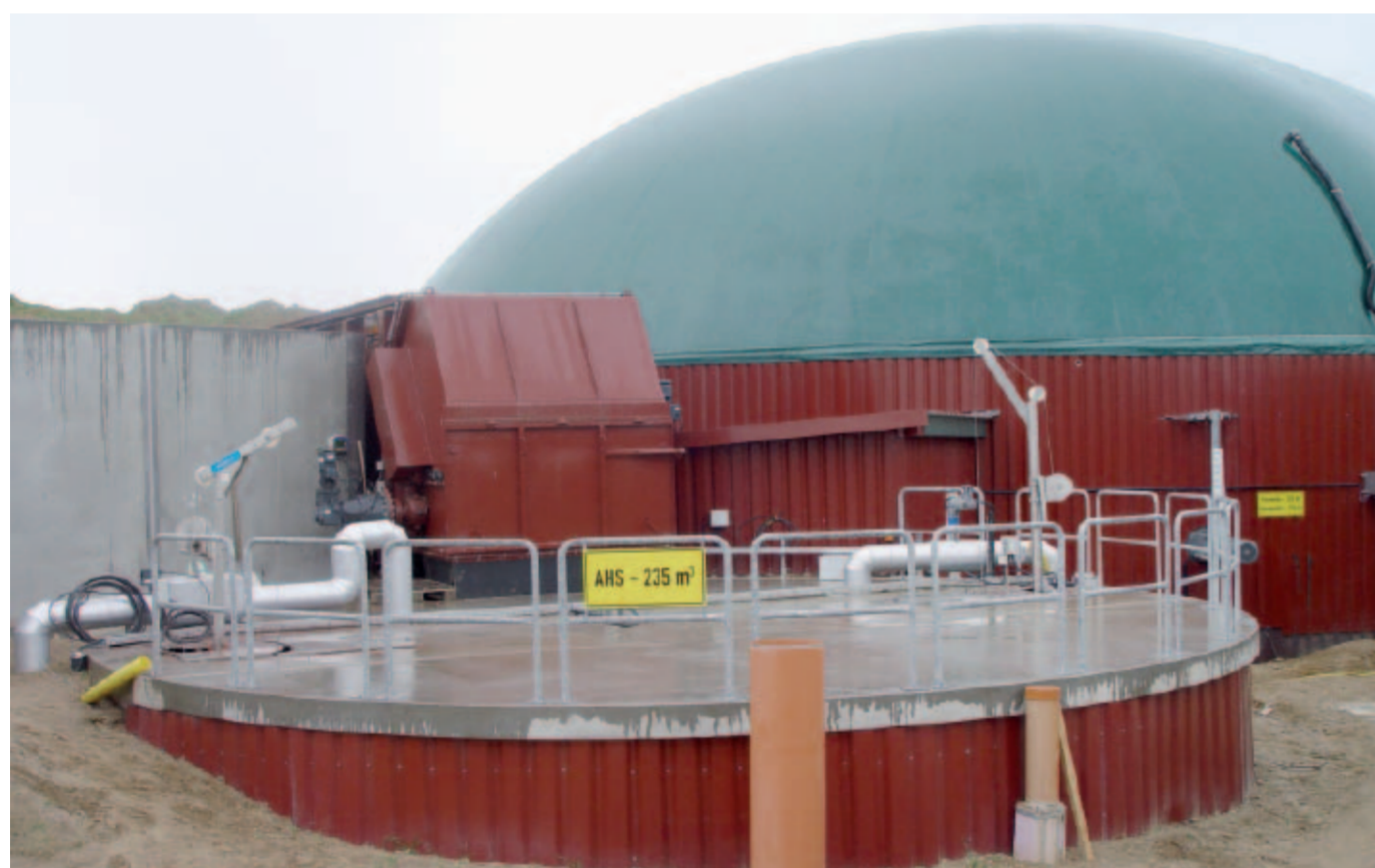
Futterbehälter mit Deckel, Anmischgrube (AHS) und Fermenter mit Gashaube
